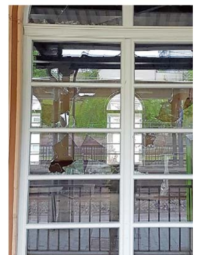
Unbekannte haben dieses erst kürzlich eingesetzte Fenster am Bahnhof in Ottweiler zerstört.
